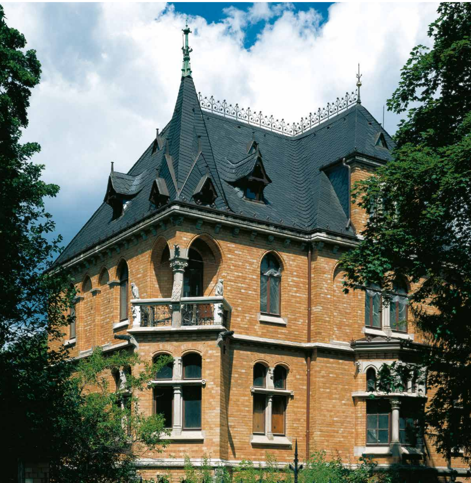
Abgestimmt auf das besondere Ambiente der Möckel-Villa in Dresden wurde bei der Neueindeckung eine historische Sonderform gewählt (Objekt während der Restaurierungsphase aufgenommen).
